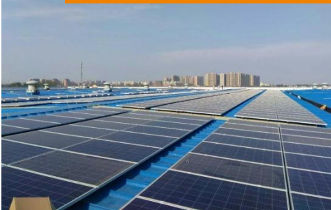
北京奔驰工厂项目 ( 0.8MW )
